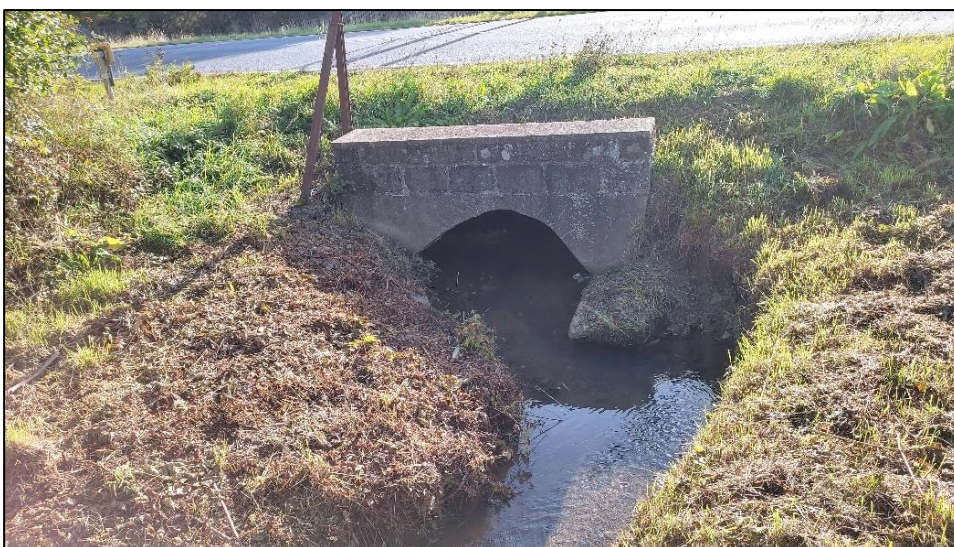
Abbildung 46: Suboptimal angeströmter Durchlass an der B 256
