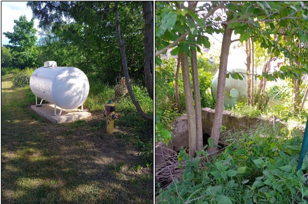
Abbildung 29: Gastanks in Gewässernähe
