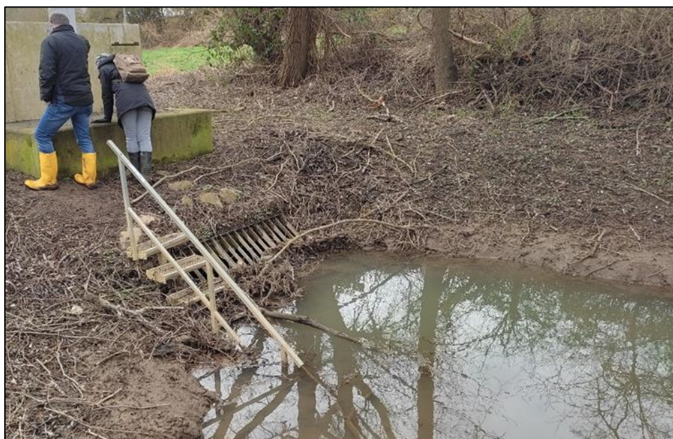
Abbildung 66: Verkläuerung am Einlaufbauwerk an der B 262
