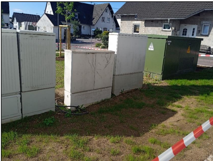
Abbildung 30: Schaltkästen auf dem Kaiserplatz in Thür
