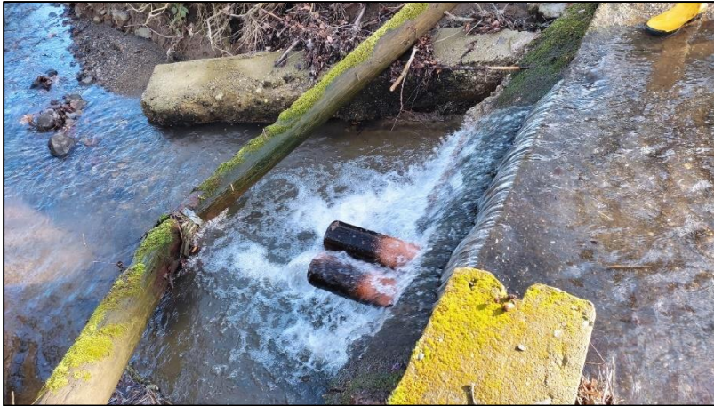
Abbildung 79: Beschädigter Sohlabsturz vor dem Geflügelhof Andres
