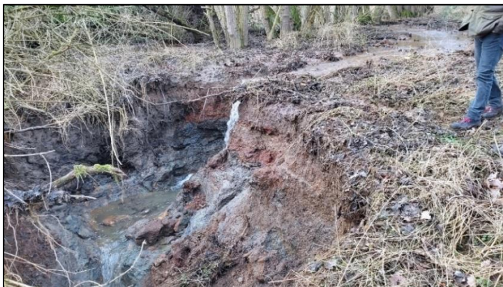
Abbildung 75: Abbruchkanten am Ufer des Segbaches
