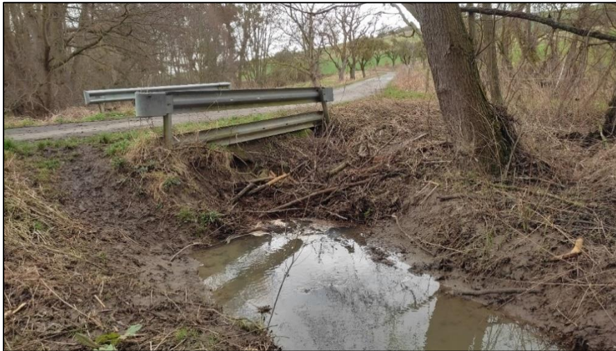
Abbildung 65: Verklauung am Durchlass „Im Dom“
