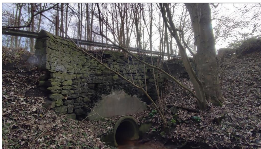
Abbildung 64: Sanierungsbedürftige Brücke in der Straße „Zum Elisabethbrunnen“, Obermendig
