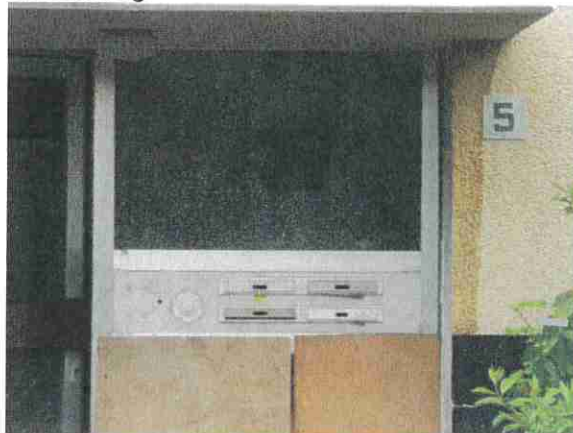
Abbildung 5: Gebäude mit Sanierungsbedarf Drosselweg
