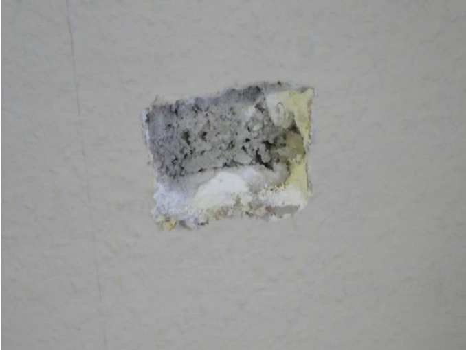
Foto 9: Büro, Detail GK Platten auf Wänden
