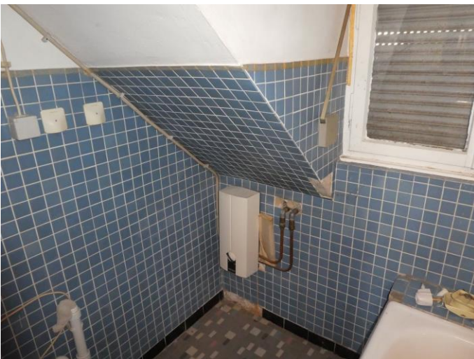
Foto 19: EFH, Bad, Fliesen im Mörtelbett
