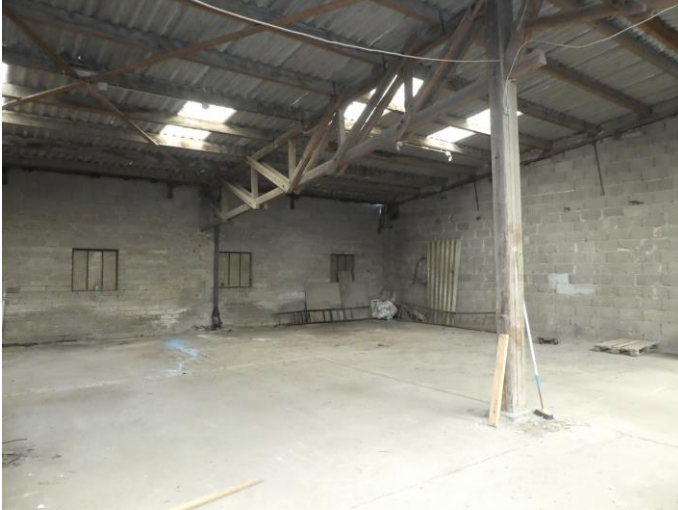
Foto 25: Produktionshalle, Tragwerk aus Holz, Boden aus Beton, kein Fugenverguss
