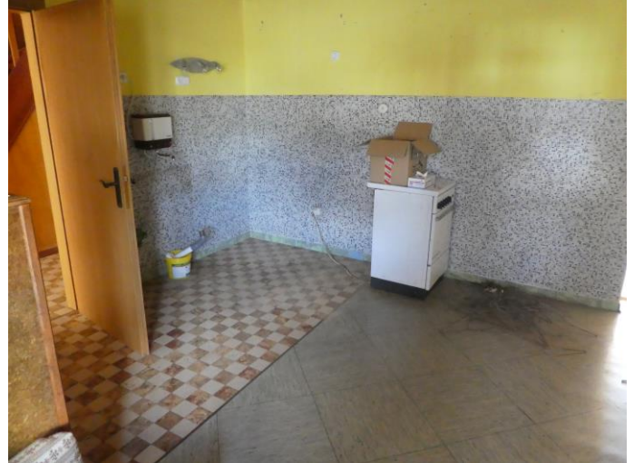
Foto 18: EFH, Küche, Fliesenspiegel, Kleber asbesthaltig
